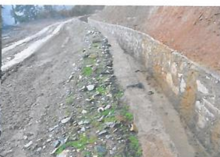
东侧南段浆砌石截排水沟
