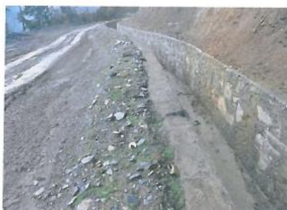
东侧南段浆砌石截排水沟
